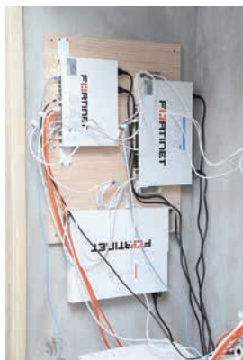
本社内に設置されたFortiGate等の機器
